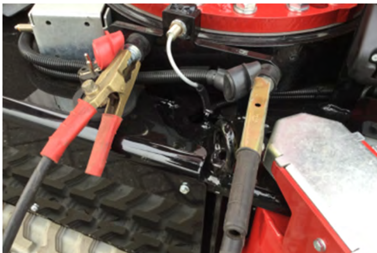
Figur 5.5 Bornes de recharge de secours
