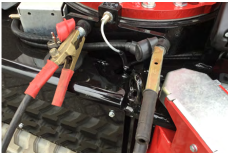
Figur 5.5 Puntos de carga de emergencia
