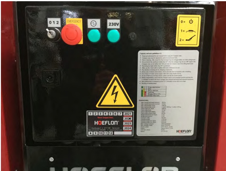
Figur 2.5 Parte exterior del armario eléctrico
