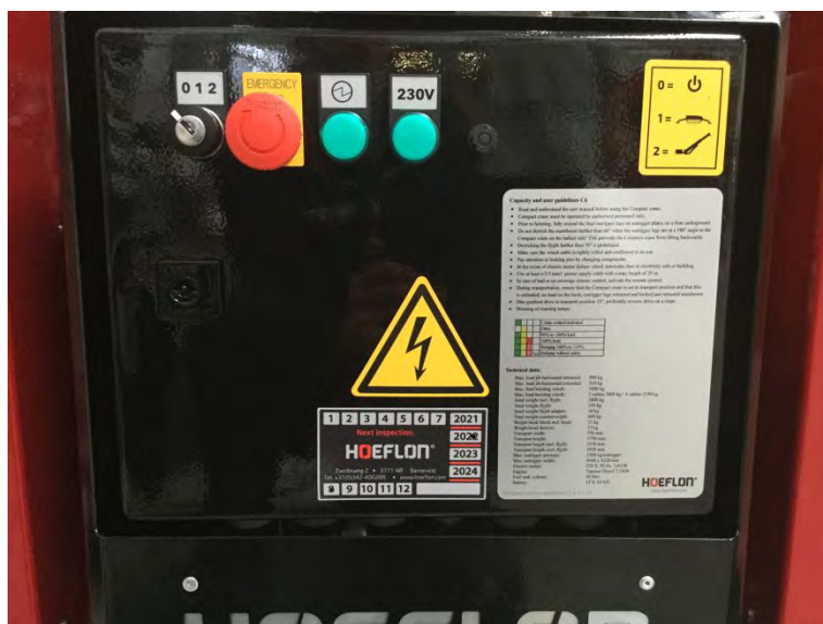
Figur 2.5 Skrzynka elektryczna na zewnątrz
