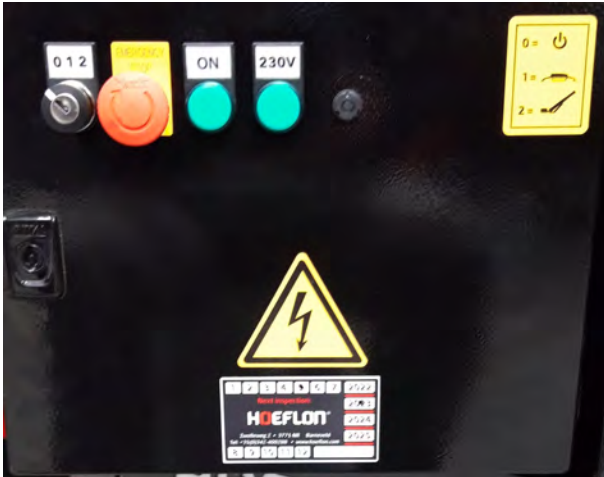
Figuur 2.5 Boîte électrique, face externe
