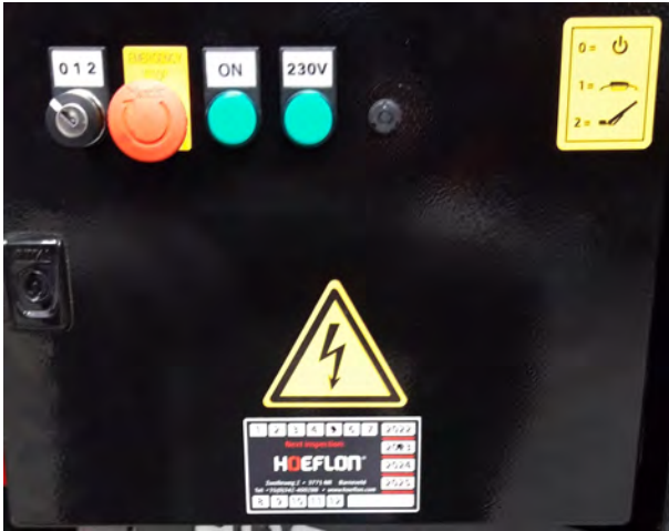
Figura 2.5 Parte exterior del armario eléctrico
