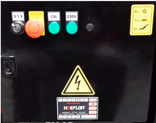
Figur 2.5 Esterno del quadro elettrico
