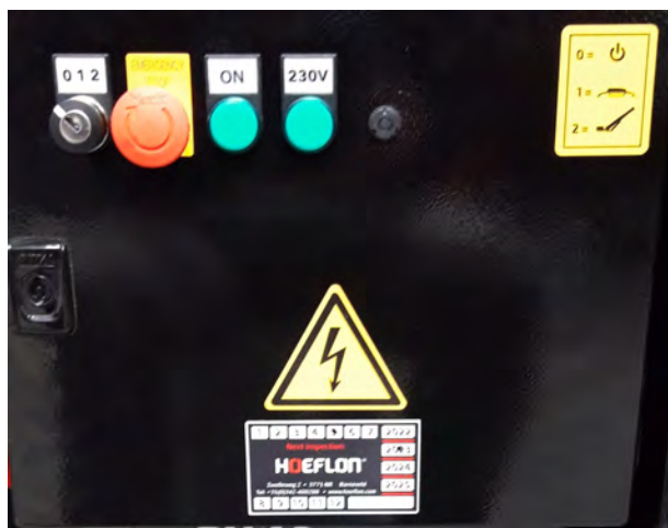
Figuur 2.5 Sikringssskap, utvendig
