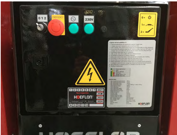
Figuur 2.5 Elektrakast buitenkant
